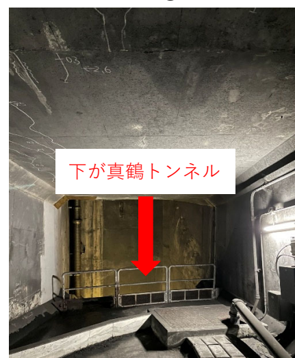
②東換気ダクト内から真鶴トンネル方向を撮影
